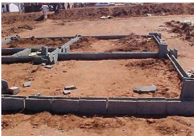
Figura 4.21 – Alguns blocos tipo canaleta quebrados e outros mal utilizados.
