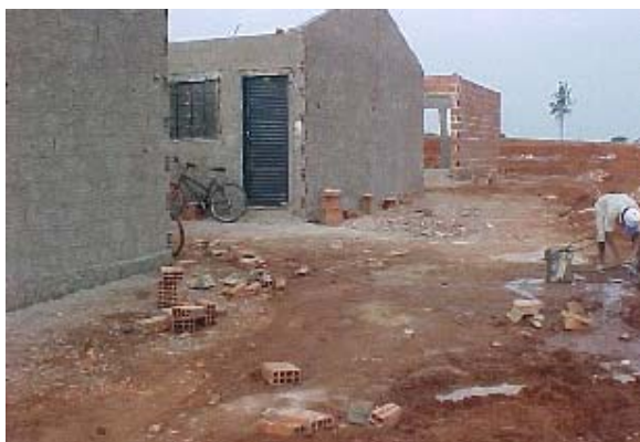
Figura 4.18 – Blocos cerâmicos espalhados mesmo depois da etapa.
