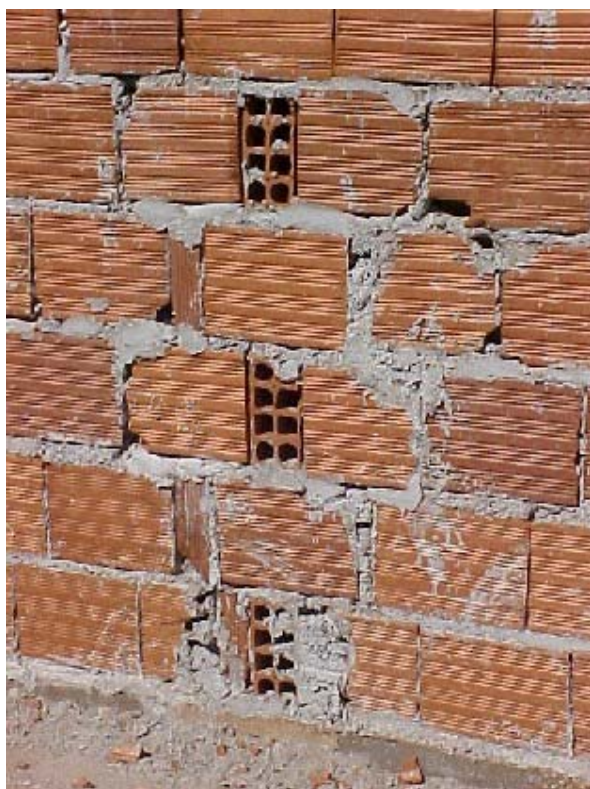
Figura 4.12 – Espessuras irregulares na argamassa de assentamento.
