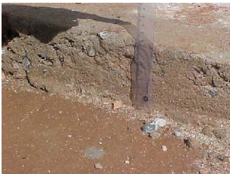
Figura 4.22 – Calçada externa com espessura desnecessária.
