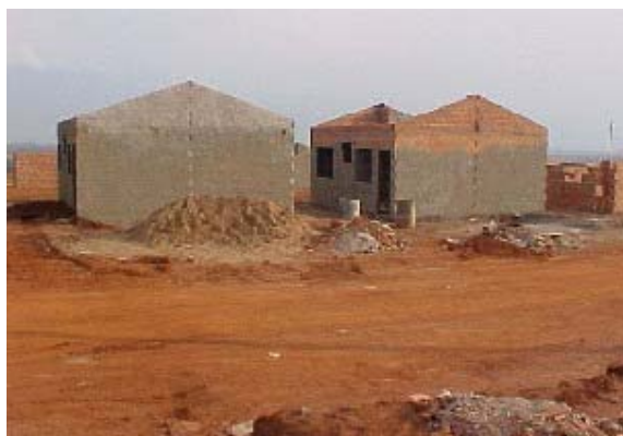
Figura 4.19 – Montes de entulho e areia esparramada.
