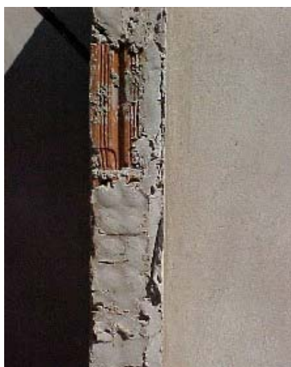
Figura 4.20 – Assentamento de blocos de forma incorreta e revestimento grosso.
