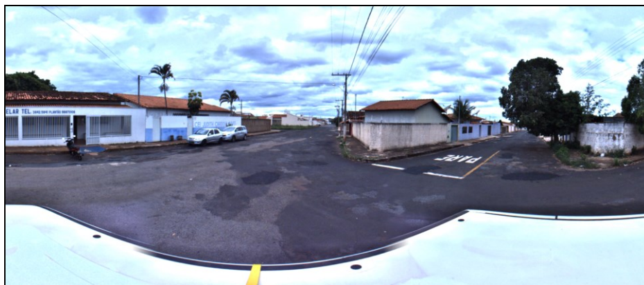
Figura 33 - Imagens Panorâmicas – visualização da condição de asfaltamento.
