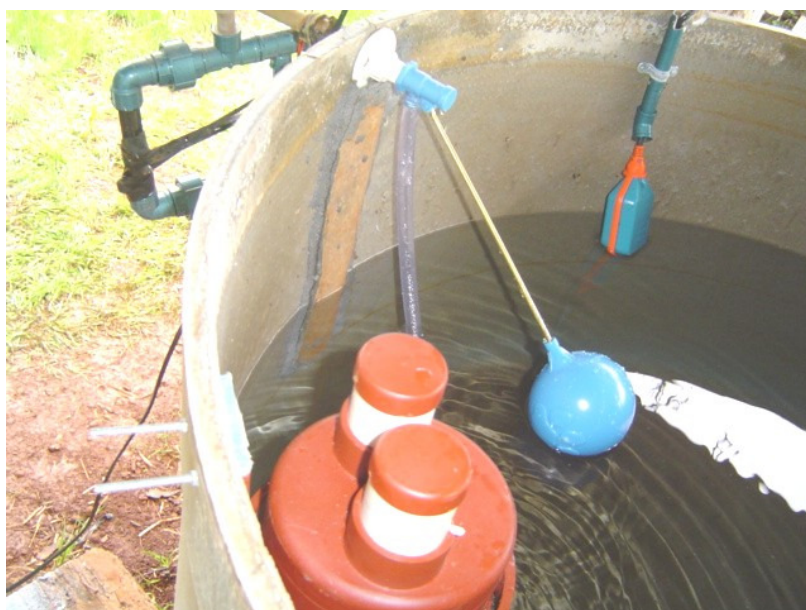
Figura 41 – Tratamento de água na caixa d'água com cloro. Fonte: REZENDE (2007).
