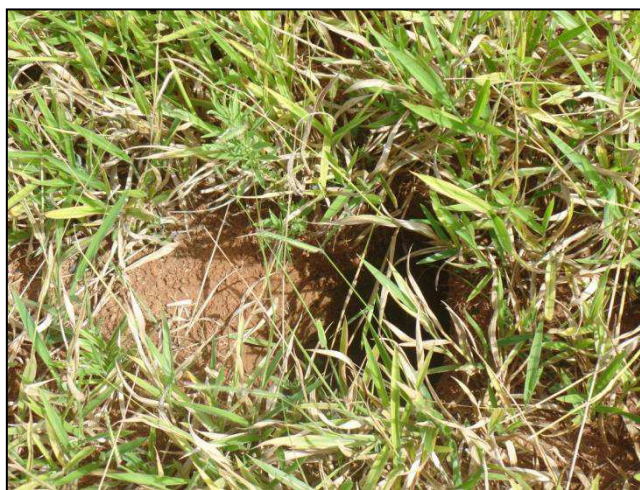
Figura 46 - Formação de piping
