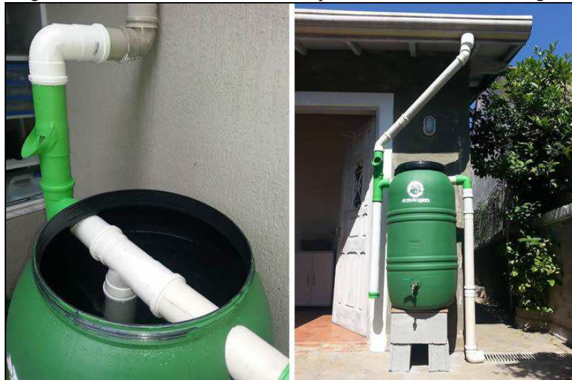
Figura 40 - Microreservatório com capacidade de 250 litros de água.
