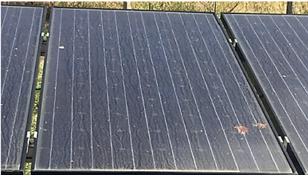
Figura 5 – Placa fotovoltaica excesso de sujeira.
