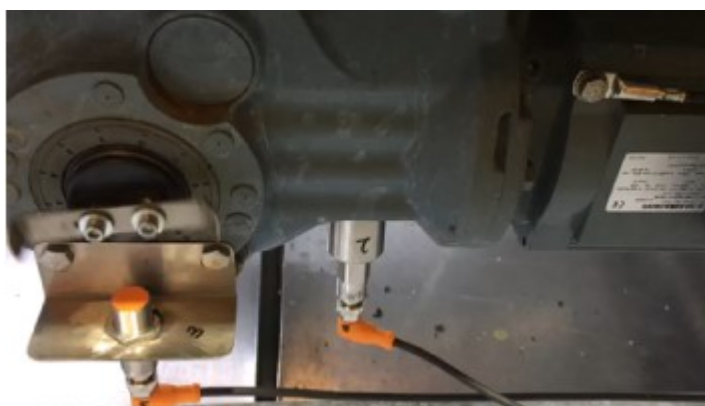
Figura 4 - Sensores acoplados a um servomotor. (Fonte: Autor)
