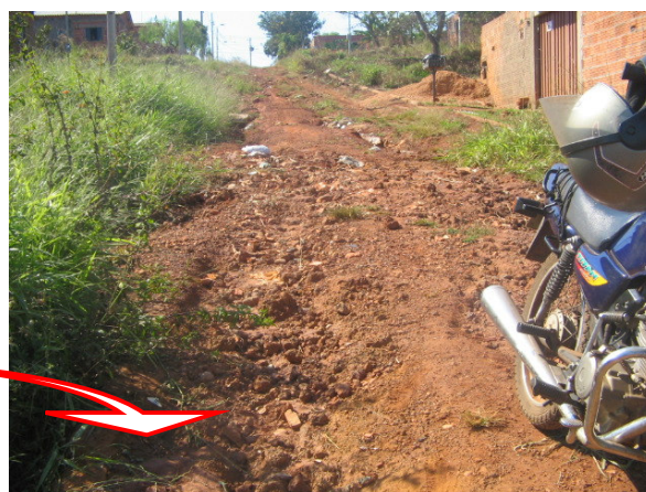
Foto 2 – Rua situada em encosta com Declividade superior a 15%, apresentando o processo erosivo nas vias sem pavimentação. Fonte: Teobaldo Neto – 28/05/2006
