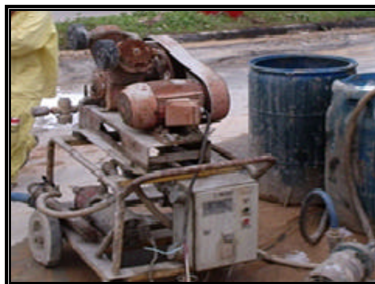
Figura 3.6 – Gerador de espuma.
