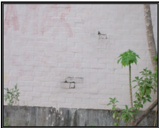
Figura C.1- Destacamentos dos tijolos nas paredes de solo-cimento rejuntado.
