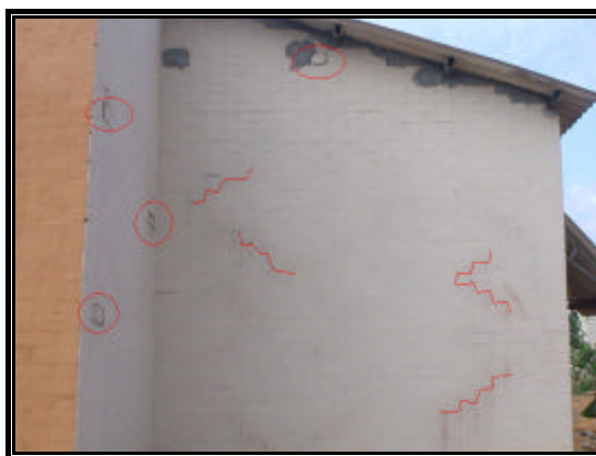
Figura 5.7 – Fissuras e destacamento de tijolos numa residência de solo-cimento rejuntado.
