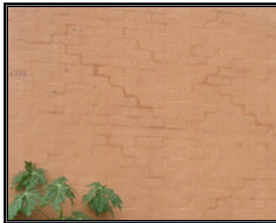
Figura C.2 – Fissuras nas paredes de solo-cimento rejuntado.
