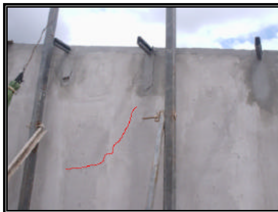
Figura 6.9 – Fissuras na parede externa e arranque dos perfis metálicos.
