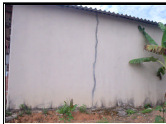
Figura 6.4 – Detalhe da fissura tratada numa casa de concreto celular parcialmente armado – ELS.
