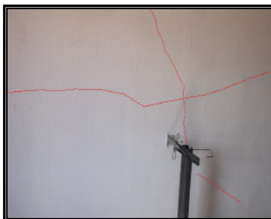
Figura 5.20 – Fissuras – Parede de concreto celular armada.
