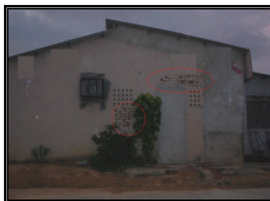
Figura 6.2 – Destacamento dos tijolos na parede de solo-cimento rejuntada – ELS.
