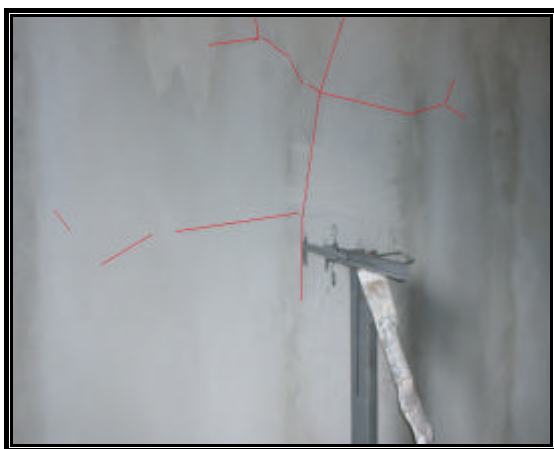
Figura 5.23 – Fissuras – Parede de concreto celular parcialmente armada.
