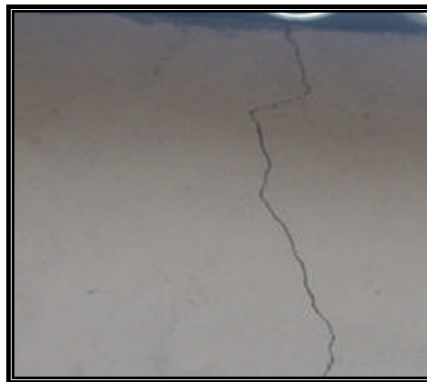
Figura C.4 – Trinca na parede de concreto celular parcialmente armado.
