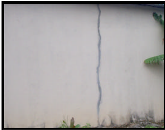
Figura C.3 – Fissura tratada na parede de concreto celular parcialmente armado.
