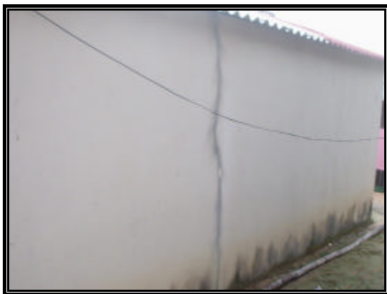
Figura 5.8 – Fissura vedada numa residência de concreto celular parcialmente armado.
