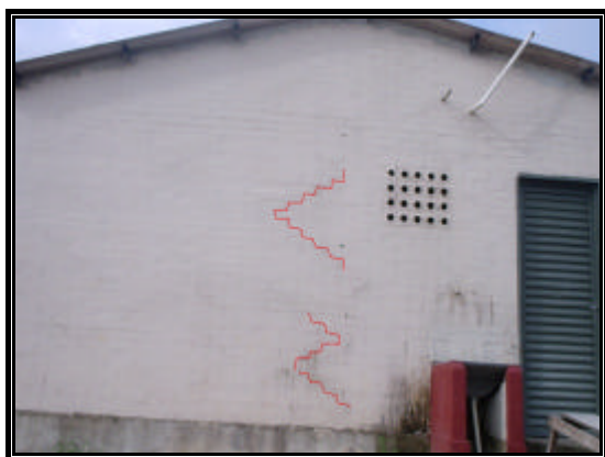
Figura 5.6 – Fissuras numa residência de solo-cimento rejuntado.
