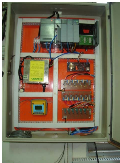
Figura 3.35 - Foto do painel elétrico principal da bancada experimental.
