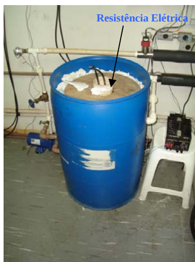
Figura 3.31 - Resistência elétrica imersa no reservatório de armazenamento térmico para o evaporador, ilustrando, ainda, o isolamento térmico utilizado.
