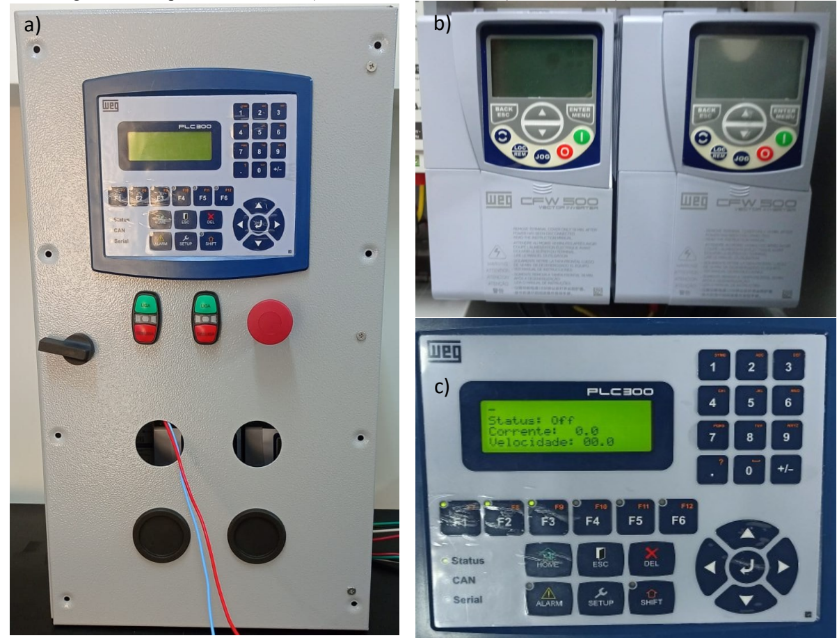
Figura 40. Foto parcial da bancada: a) sistema de acionamento; b) conversores; c) IHM em estado inicial.
