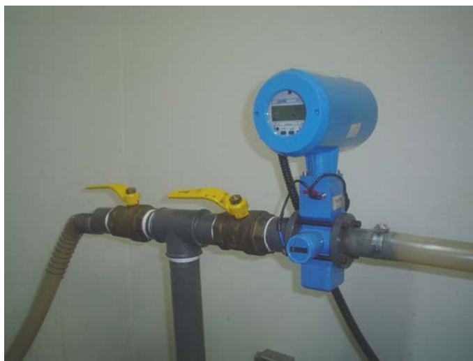
Figura 3.15: Válvulas e medidor magnético de vazão
