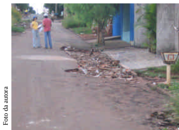
Figura 4.62 – Buracos aterrados com entulho pelos moradores.
