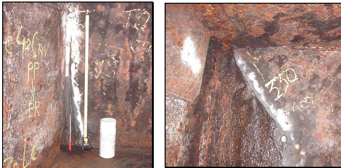
Figura 1.1: Trincas em tanques de armazenamento de um FPSO da PETROBRAS (SOUZA, 2006).
