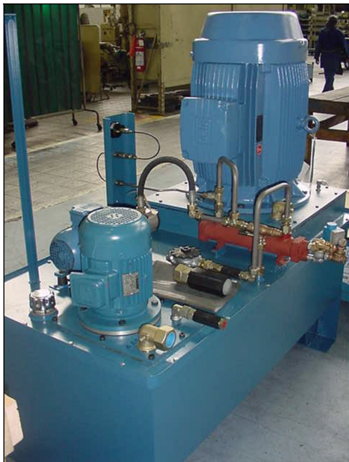
Figura 3.6: Foto da unidade hidráulica – Reservatório de óleo e moto-bombas.
