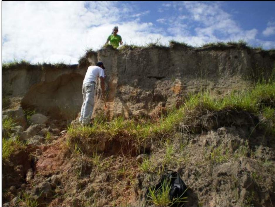
Figura 31: Ponto de coleta de amostra em um dos taludes de erosão. Autor: GIFFONI, S. Data: 18 jan. 2009.
