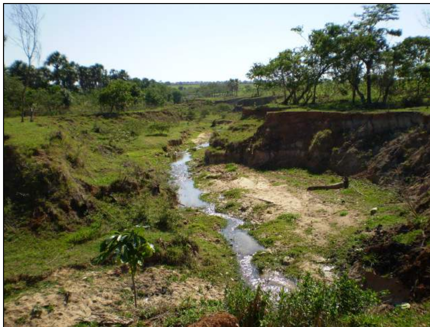
Figura 57: Visão geral da feição erosiva. Autor: GIFFONI, S. Data: 23 out. 2009.
