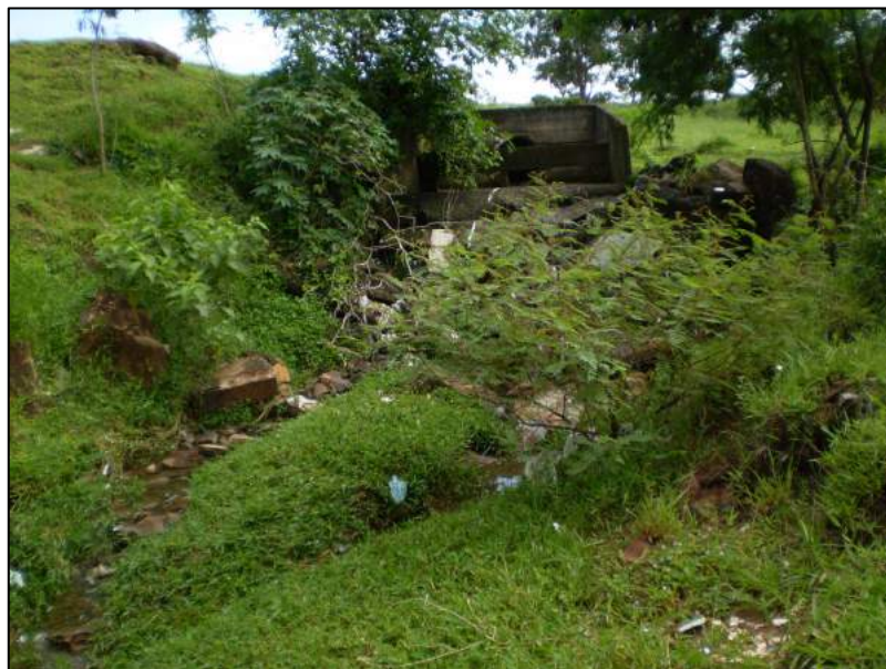
Figura 18: Segundo local de lançamento de galeria pluvial aterrado em 2004. Autor: GIFFONI, S. Data: 16 jan. 2009.
