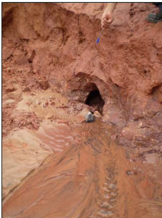
Figura 60: Canal aberto pelo piping na altura do nível P4N4. Autor: GIFFONI, S. Data: 06 out. 2009.
