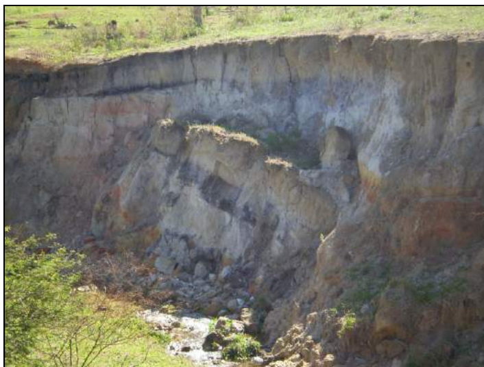
Figura 58: Queda de blocos por falta do suporte carreado. Autor: GIFFONI, S. Data: 23 out. 2008.
