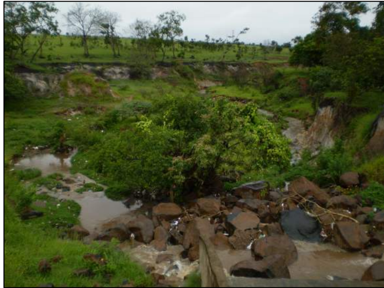
Figura 17: Detalhe da canalização Pluvial sobre a área erodida. Autor: GIFFONI, S. Data: 19 jan. 2009.
