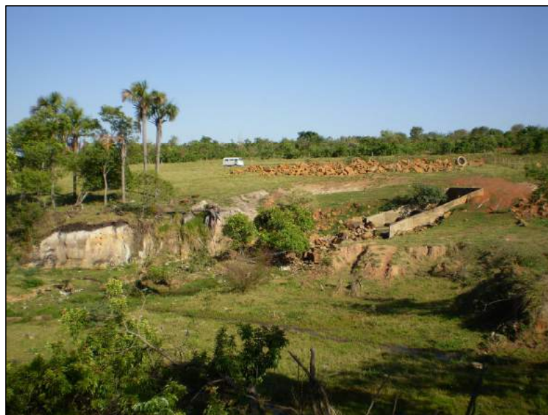
Figura 16: Galeria de lançamento pluvial a partir de onde evolui a feição erosiva. Autor: GIFFONI, S. Data: 23 out. 2008.
