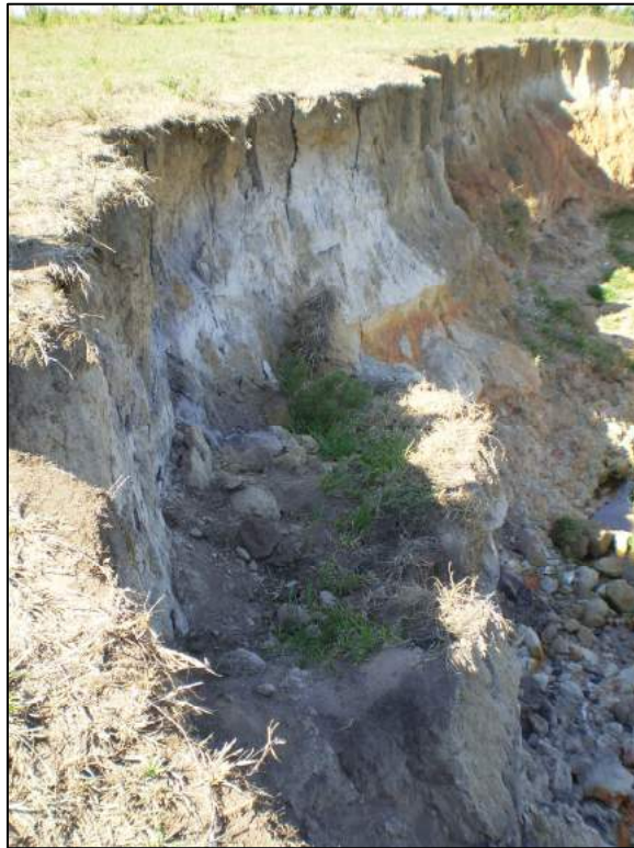
Figura 24: Os blocos de solo que se desprendem após a ruptura do talude e se acumulam na sua base. Autor: GIFFONI, S. Data: 23 out. 2008.
