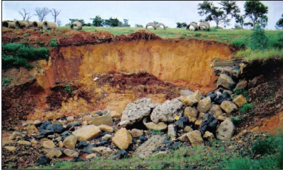
Figura 13: Segundo ponto de lançamento de água pluvial com evolução da feição erosiva. Autor: NISHIYAMA, 2003.
