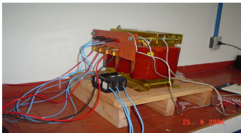
Figura 5.2 – Detalhe do transformador trifásico a seco de 5 kVA.
