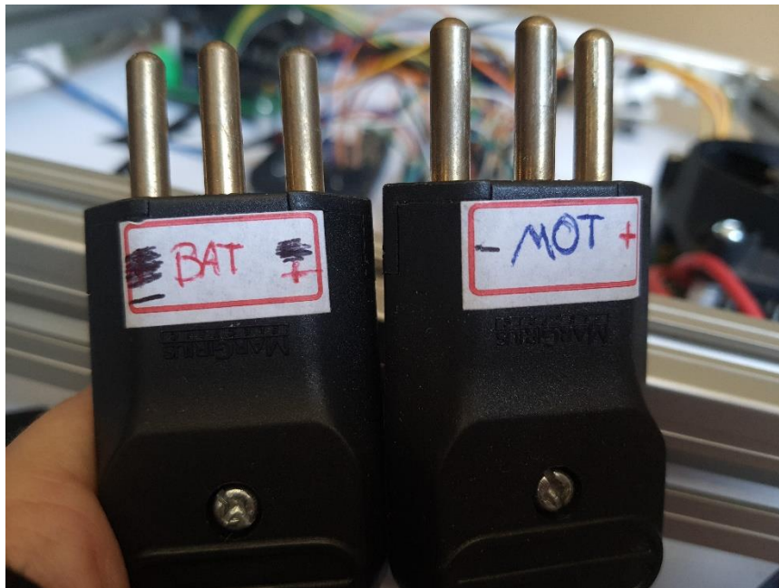
Figura 31. Plugs machos tipo N, com identificação da bateria e do motor.
