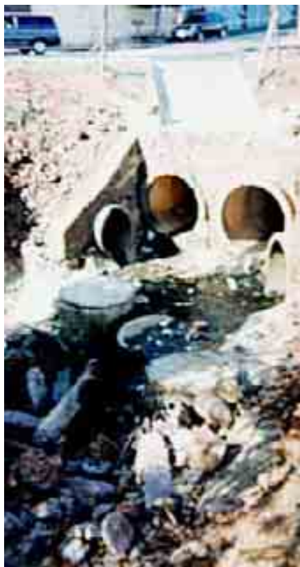
Figura 12 - Trecho visível do Buritizinho, após nascente aterrada, entulho carreado pela chuva. Foto: Ozanam, F. - 2004
