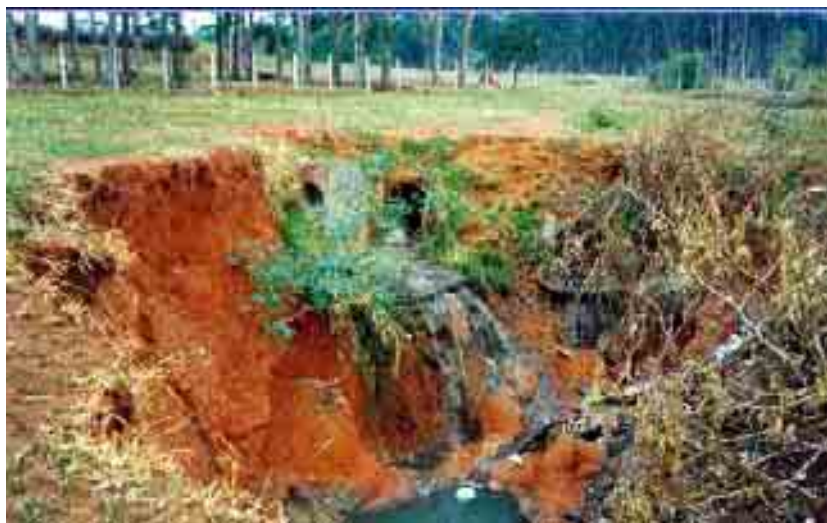
Figura 9 – Lançamento de rede que gera a voçoroca do Bairro Cruzeiro do Sul. Foto: Ozanan, F – 2003.
