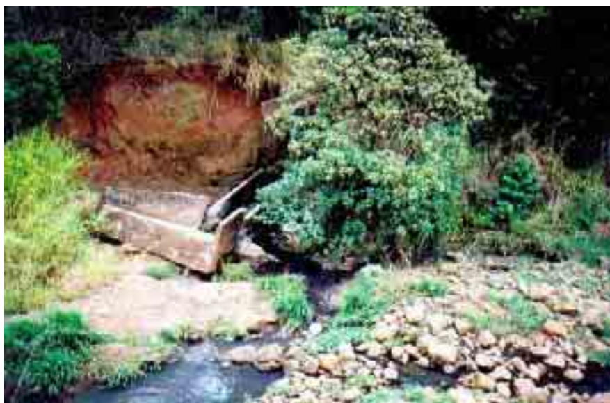
Figura 10 – Processo erosivo nas margens do Córrego Liso, comprometendo o dissipador, observar também a sedimentação de material sólido no leito. Foto: Ozanam, F. – 2003
