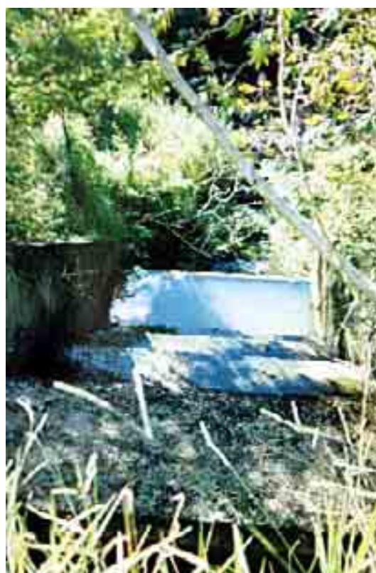
Figura 18 – Vista Superior do Dissipador acima, observar a bacia de retenção da água de chuva no final.
