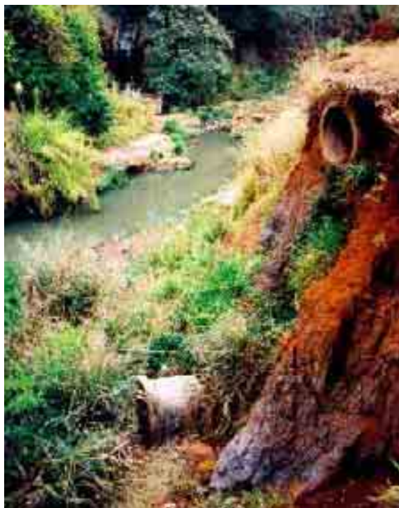
Figura 15 – Rompimento de rede e de dissipador por processos erosivos no canal do Córrego Liso. Foto: Ozanam, F. – 2003.
