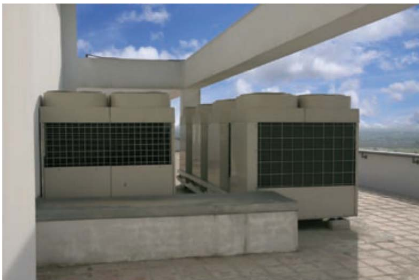
Figura 2.9 – Sistema de Ar Condicionado Central no topo de um edifício.
