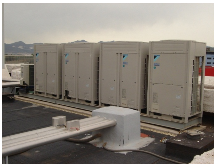
Figura 2.15 - Sistema VRV instalado na cobertura de um edifício.
