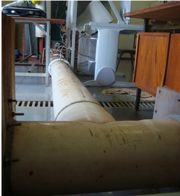
Figura 47 – Tubulação de ar
