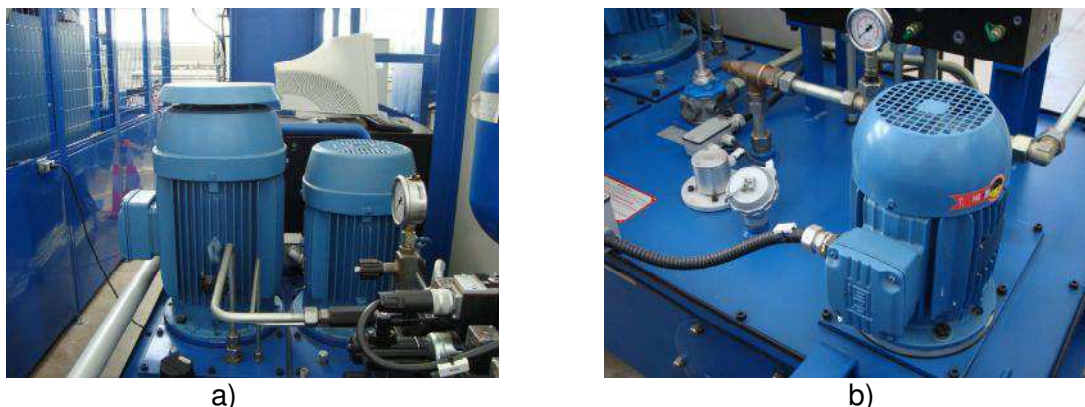
Figura 2.7 – Motores elétricos do sistema hidráulico: a) Motor do sistema de oscilação e motor do sistema de compressão, b) Motor do sistema de recirculação de óleo.
