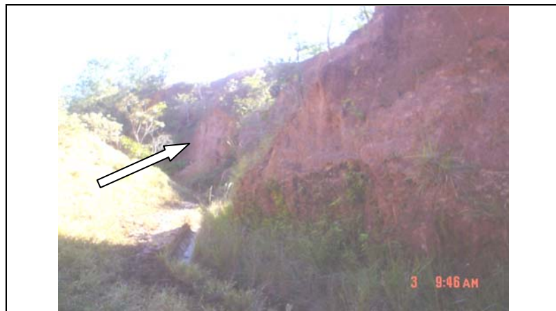
FIGURA 3.56: Perfil da voçoroca instalada na base do aterro, onde se extraiu as amostras de solo indeformada.
