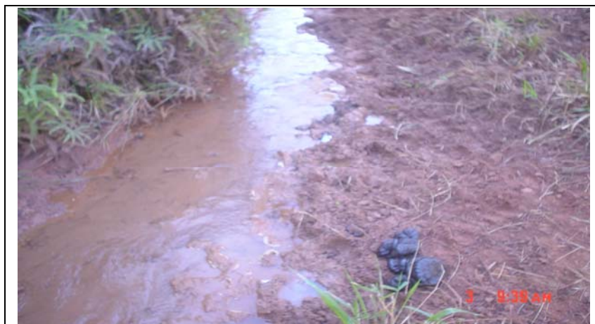
FIGURA 2.38: Indícios da presença de gado no fundo da calha do aterro.
