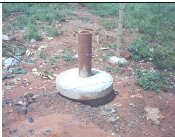
FIGURA 2.24: Dreno para gases instalados na área
