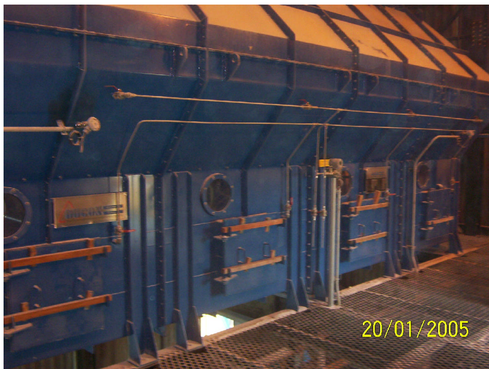
Figura A7.1- Vista Lateral do Corpo do Leito Fluidizado Industrial
