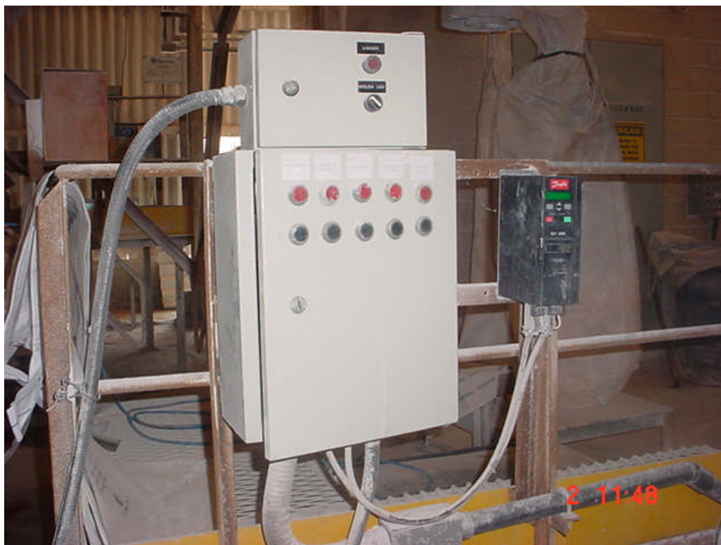
Figura A1.4- Painel de Força e Controle do Sistema de Fluidização
