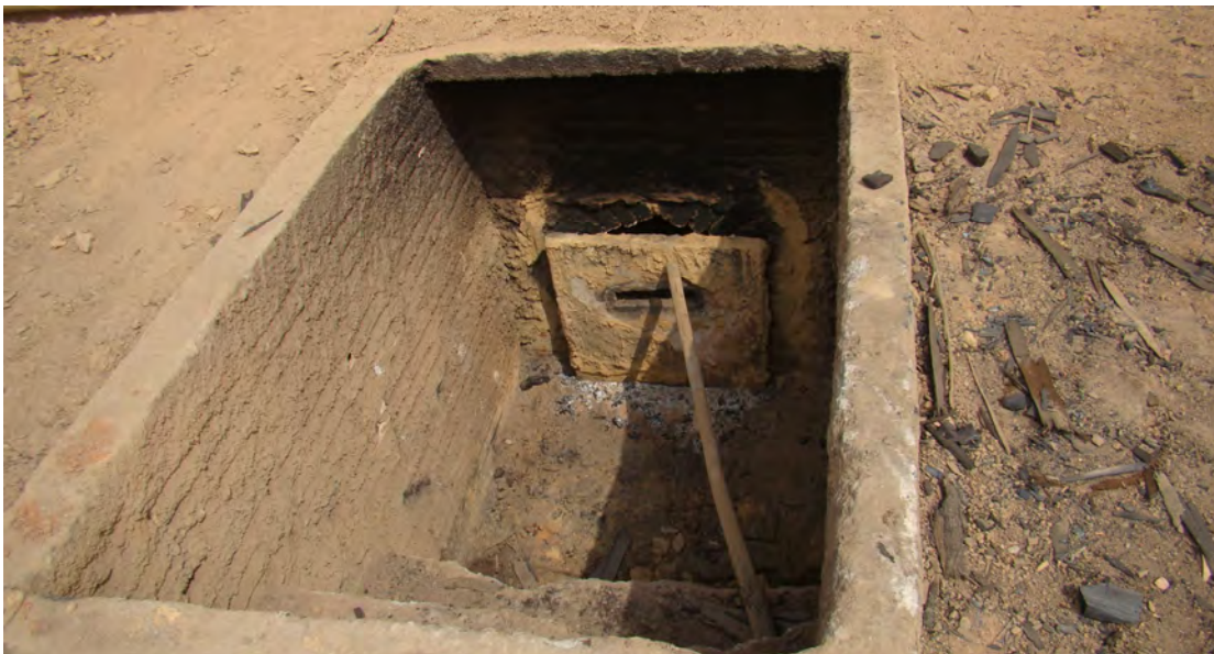
Figura 4.6 – Controle das câmaras centrais
