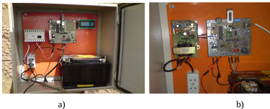
Figura 3.6 – Central de aquisição: a) Armário instalado contendo a central de aquisição; b) Detalhe do circuito instalado - última versão
