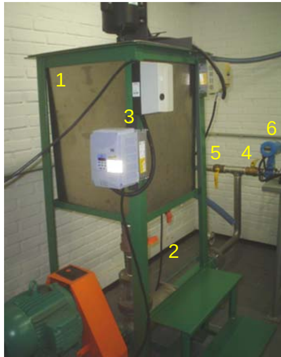
Figura 6.4: Bomba helicoidal, tanque, válvulas para ajuste da vazão e o medidor magnético de vazão.
