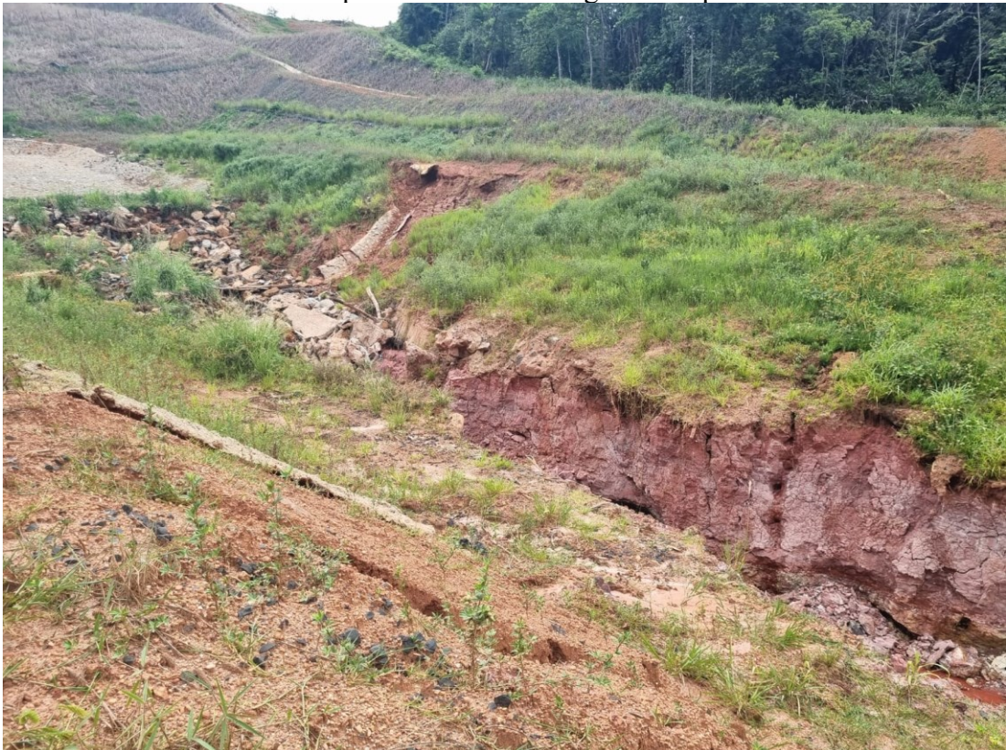
Figura 15 - Desprendimento do solo na canaleta de água pluvial e consequentemente o carregamento dos sedimentos para o leito do Córrego Desamparo.
