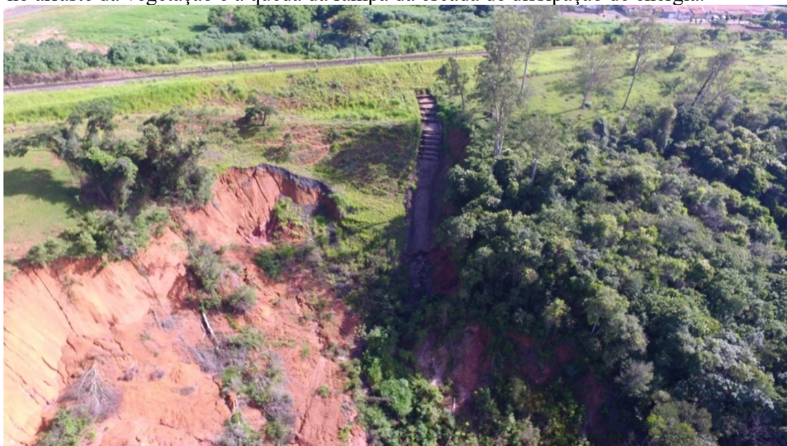
Figura 12 - Vista do drone da área à jusante a via férrea, com o desprendimento de solo, no arraste da vegetação e a queda da rampa da escada de dissipação de energia.
