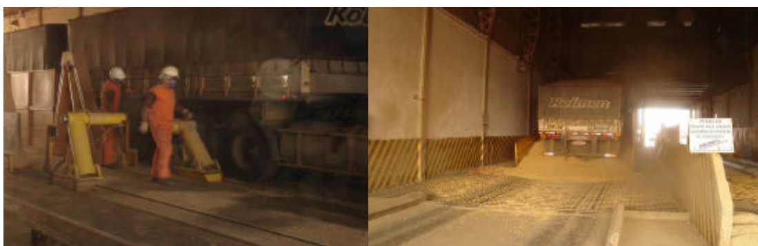
Figura 4.13 - Tombador na BUNGE Alimentos (aparelho de descarga)
