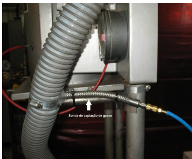
Figura 3.11 – Detalhe da posição de montagem da sonda de captação de gases
