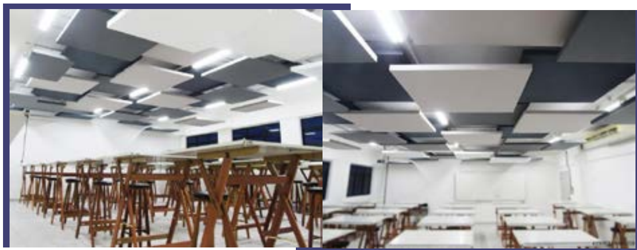
Figura 11: sala de aula da Faculdade UNIME em Lauro de Freitas (BA) com nuvens acústicas.
