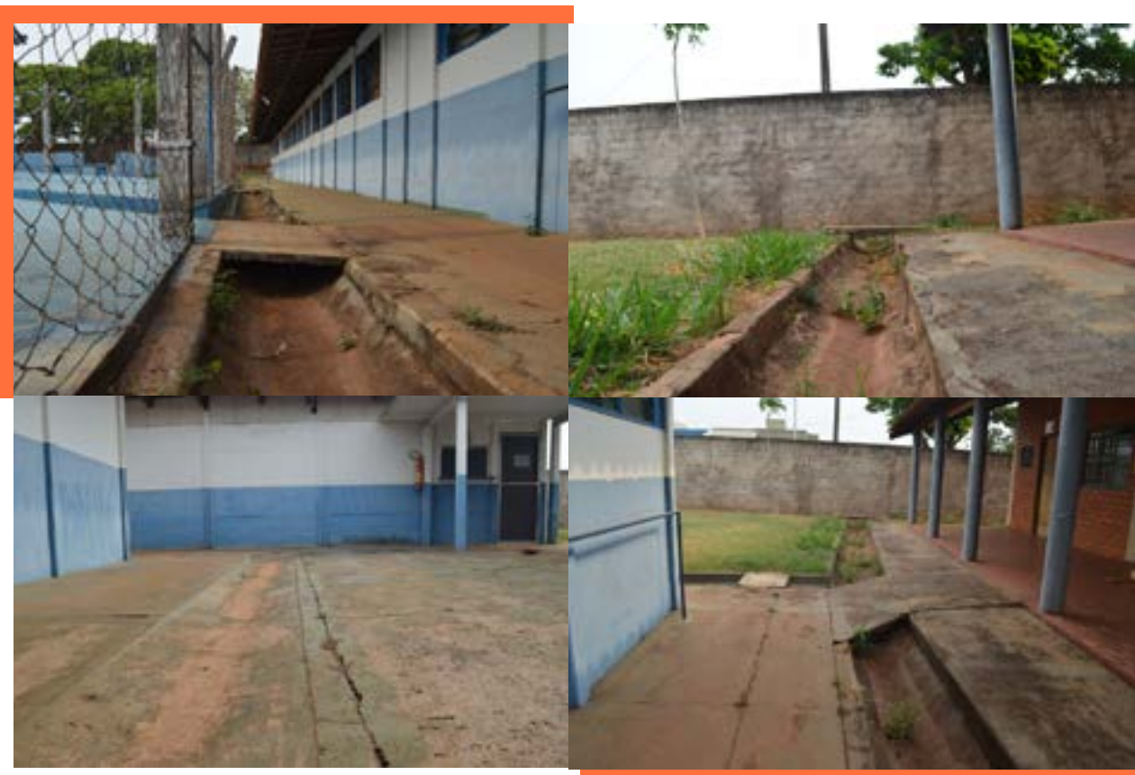
Figura 44: canaletas de drenagem de águas pluviais.
