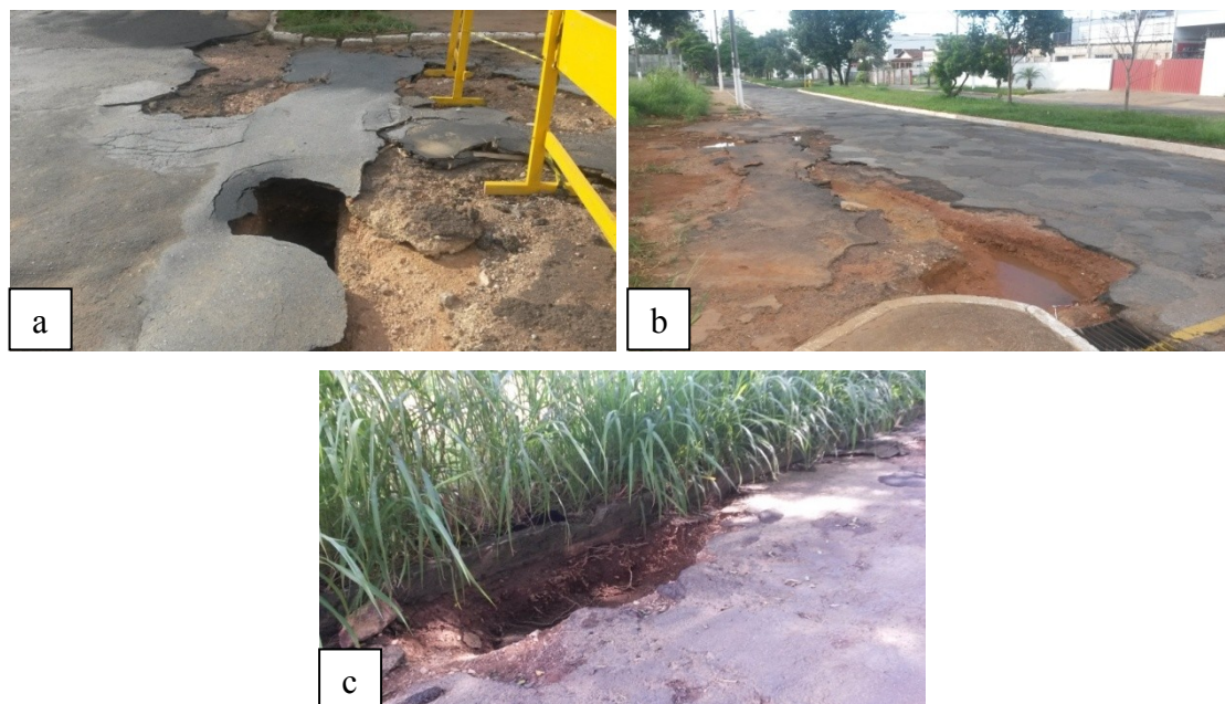
Figura 8 (a, b, c): Cavidades na pavimentação em Patrocínio, MG.
