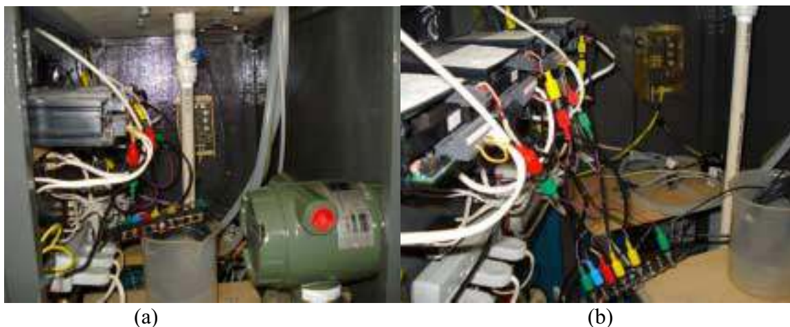
Figura 7.45 - Circuitos elétricos da instrumentação da planta experimental.
