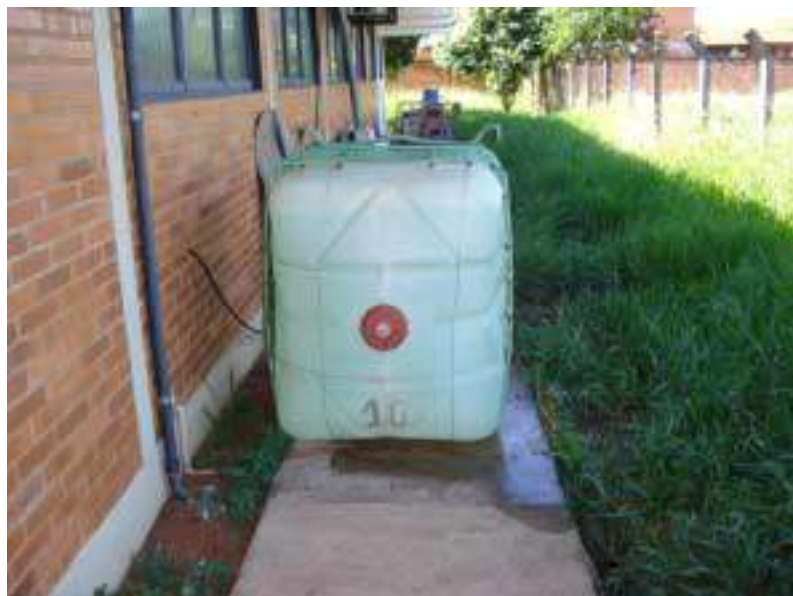
Figura 5.5 - Tanque alternativo para armazenamento de água filtrada.
