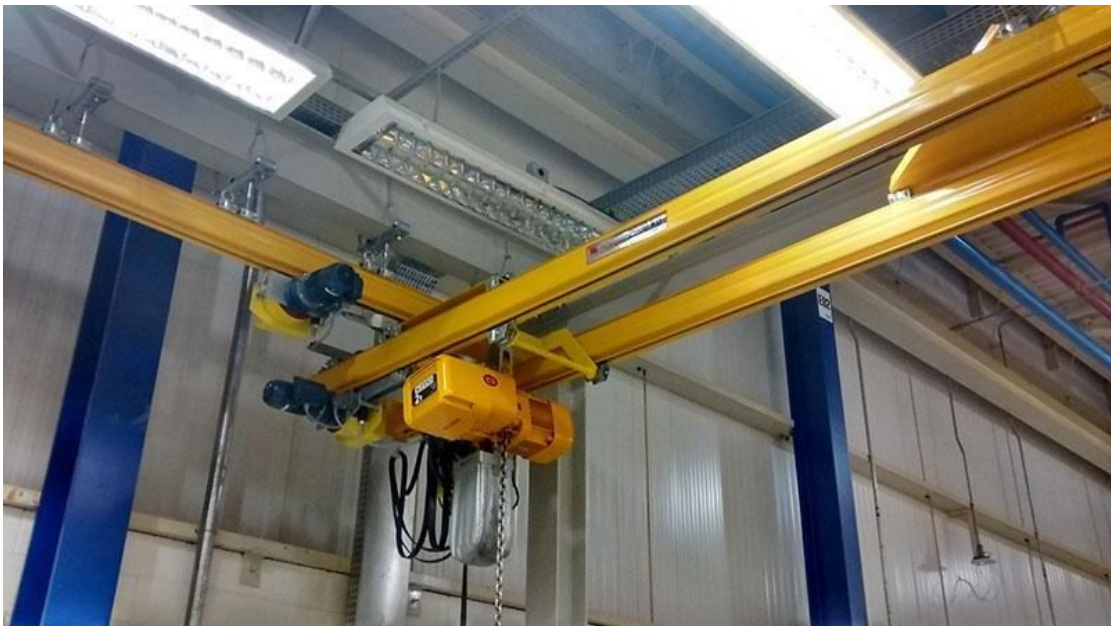
Figura 4 – Exemplo de ponte rolante bi-viga
