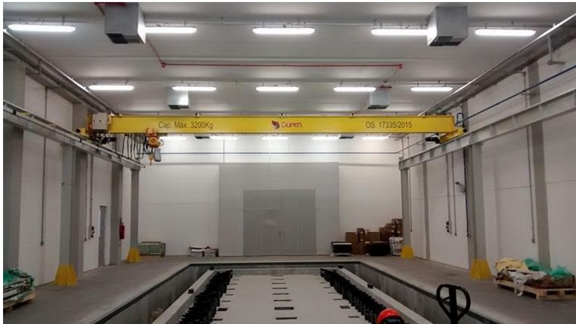
Figura 2 - Ponte rolante univiga
