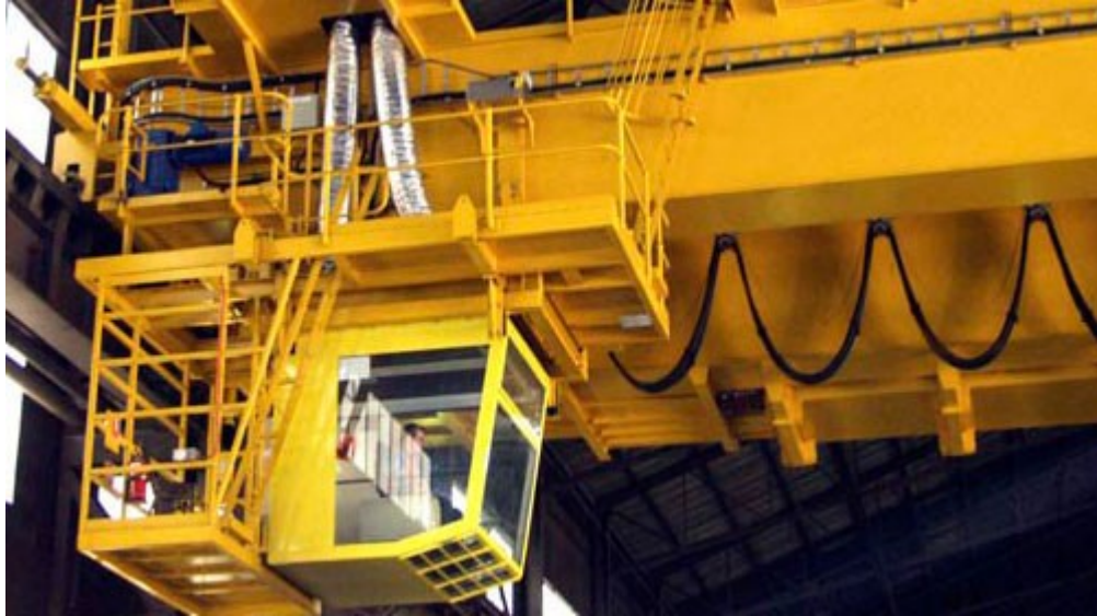
Figura 9 – Cabine de ponte rolante
