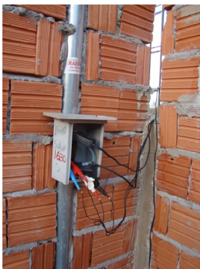
Figura 5.69 - Medição da tensão e corrente da rede elétrica no padrão da casa popular.
