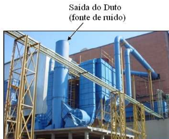
Figura 2.2 – Sistema de exaustão instalado em uma indústria
