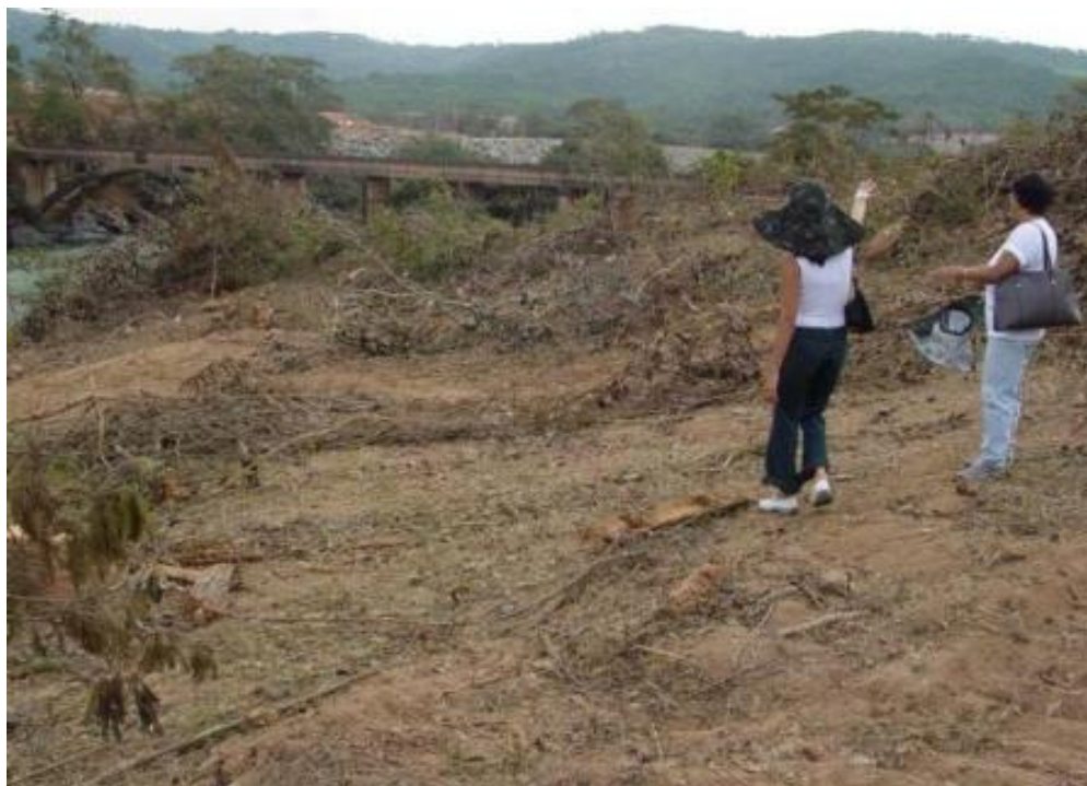
Foto 34: Local onde se situava o ponto de captura próximo a margem do rio Araguari, após a derrubada da mata ciliar.
