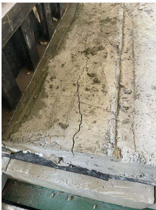
Figura 21 — Laje 3CT - Ruptura
