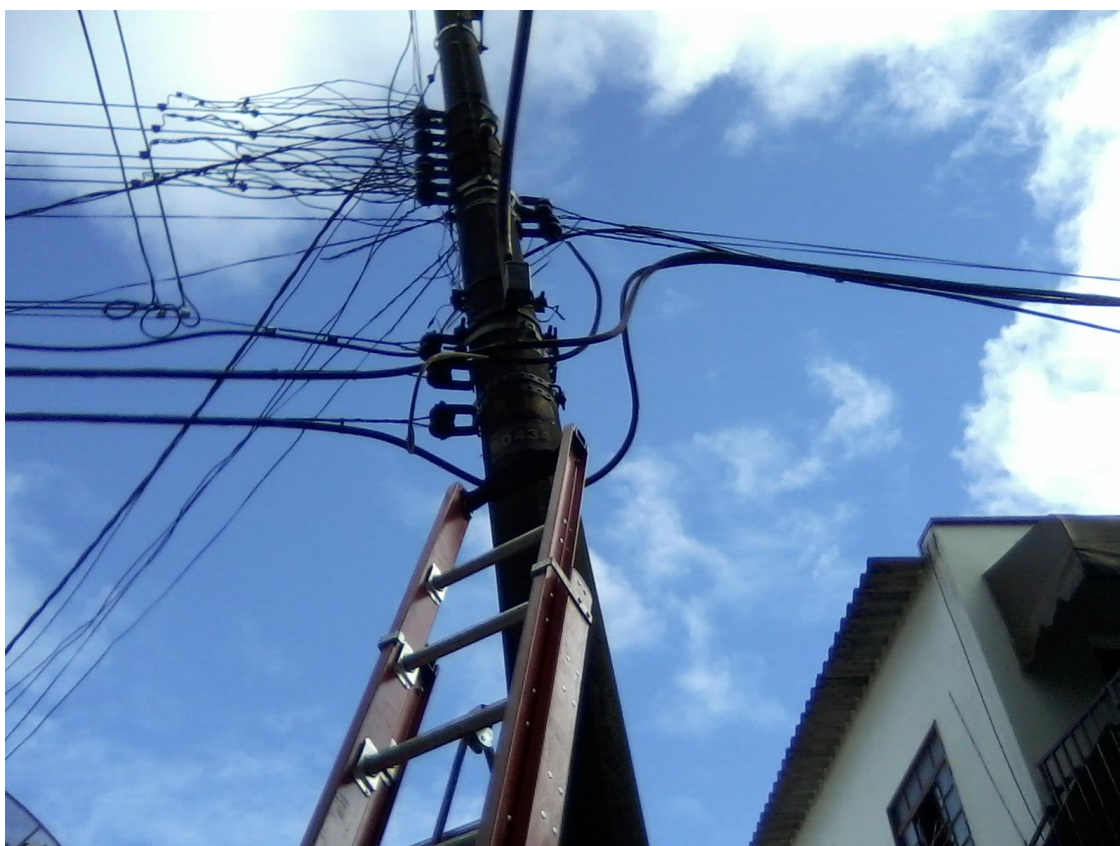
Imagem 21: Poste com cabeamento: Fotografia de Lino Pereira, meu pai (agosto de 2012) 64
