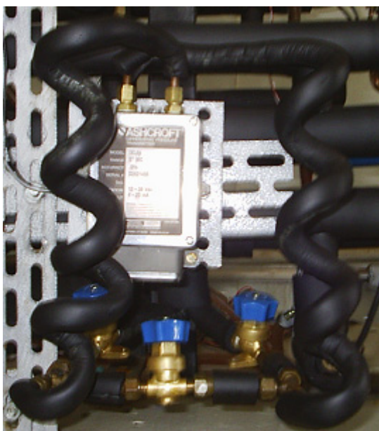
Figura 3.10. Foto do transdutor diferencial pressão instalado no sistema
