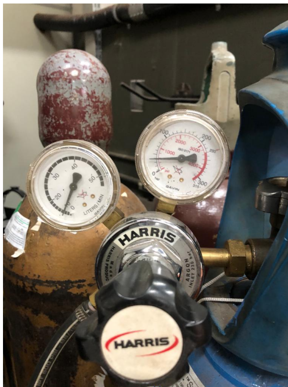
Figura 16- O manômetro de pressão de gás e o medidor de vazão
