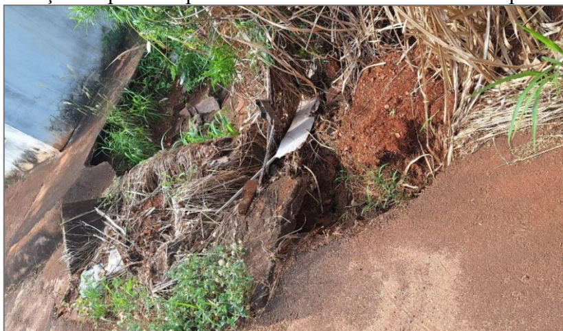
Figura 59: Destruição de parte do pavimento devido ao escoamento superficial concentrado
