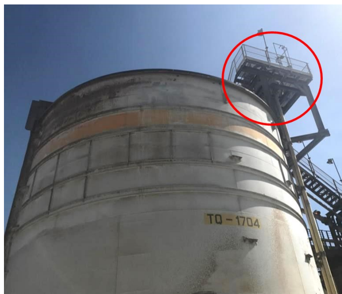
Figura 4.51: Ponto de alimentação do ATMP ao tanque de cura
