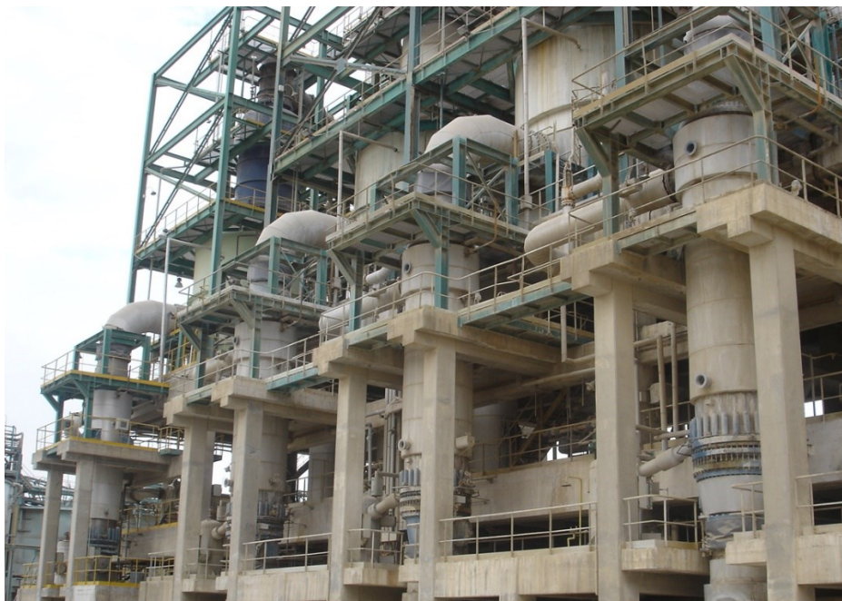
Figura 2.26: Trocadores de calor para ácido fosfórico (do autor)
