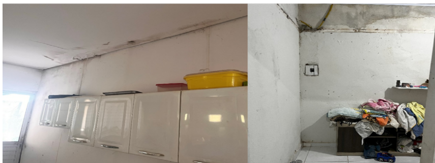
Figura 3.17 -Ocorrência de mofo/bolor no R2A4 (à esquerda) e RSB (à direita).
