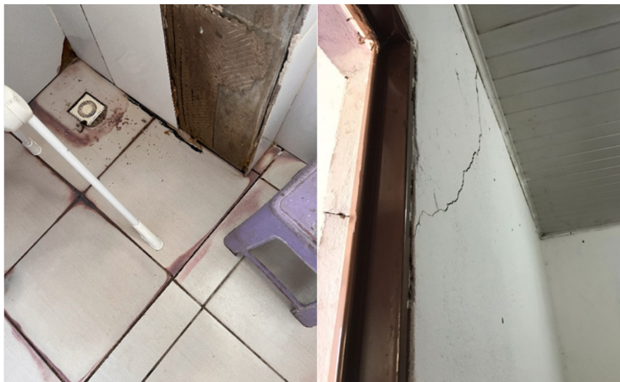
Figura 3.33 - Patologias recorrentes no R2A4 (à esquerda) e no RSB (à direita).
