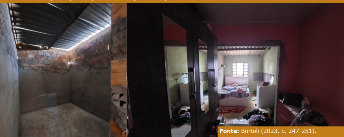
Figura 3.36 - Ampliações sem previsão de aberturas ou aberturas insuficientes no R2A4 (à esquerda) e no RSB (à direita).
