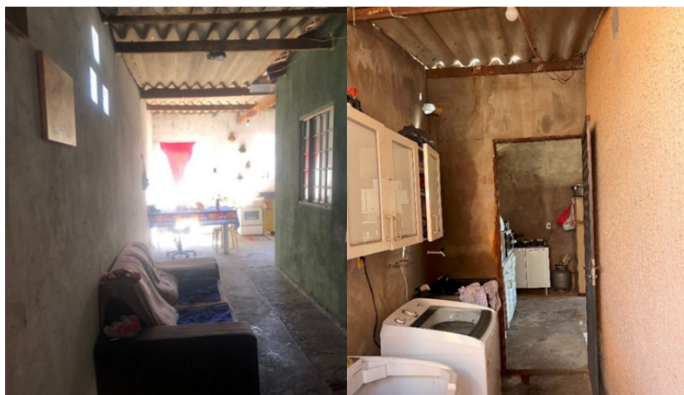
Figura 3.24 - Presença de frestas em telhados no R2A4 (à esquerda) e externamente no RSB (à direita).
