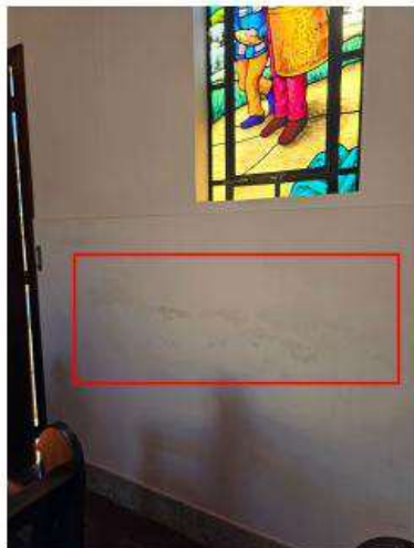
Capela de Nossa Senhora do Rosário: manchas de umidade. Foto: Tony Rodrigues, 06/11/2024
