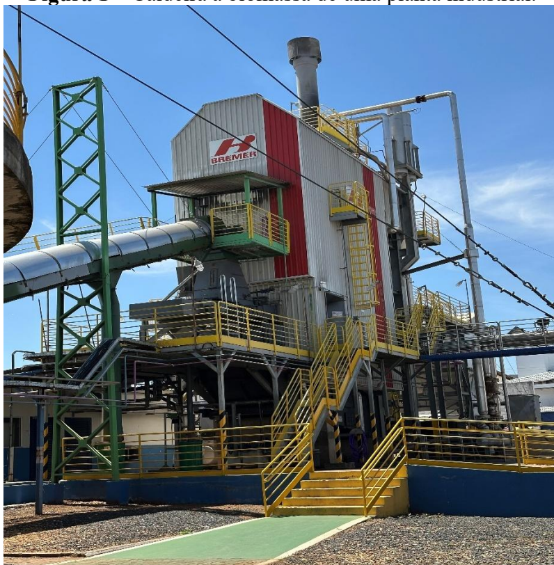
Figura 1 – Caldeira a biomassa de uma planta industrial.
