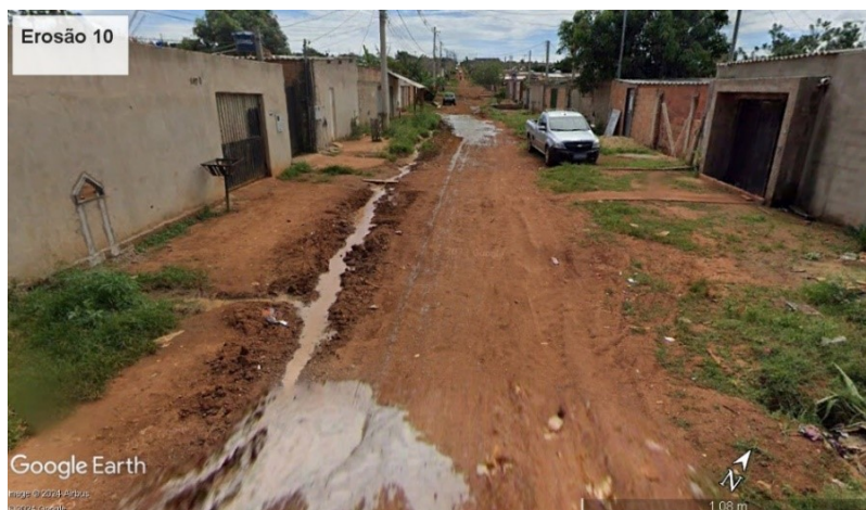
Figura 17. Erosão localizada no terceiro quarteirão da avenida Karl Marx
