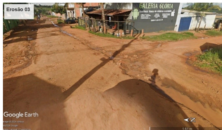
Figura 10. Erosão localizada no início da avenida Karl Marx
