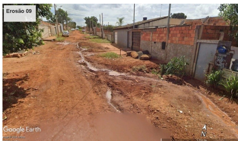
Figura 16. Erosão localizada no final da rua Antônio Nunes de Souza
