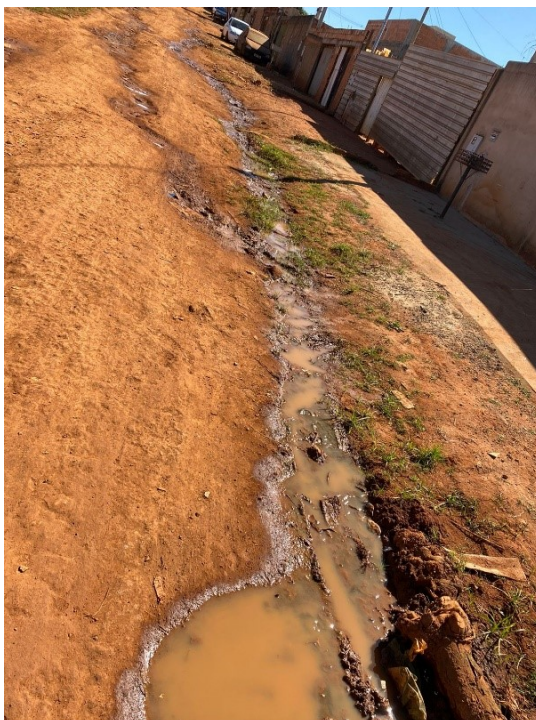
Figura 2. Erosão no bairro Élisson Prieto
