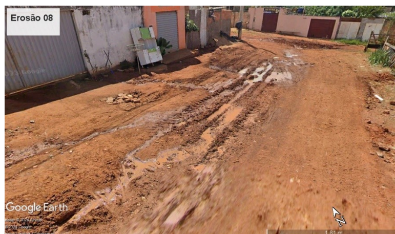
Figura 15. Erosão localizada em uma rua não identificada pelo Software Google Earth
