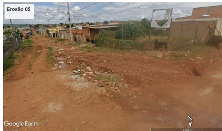
Figura 12. Erosão localizada no início da rua Paulo Alexandre Garcia
