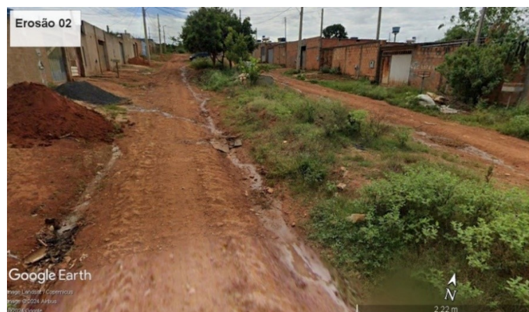
Figura 9. Erosão localizada na rua Antônio Messas de Arcanjo de Oliveira
