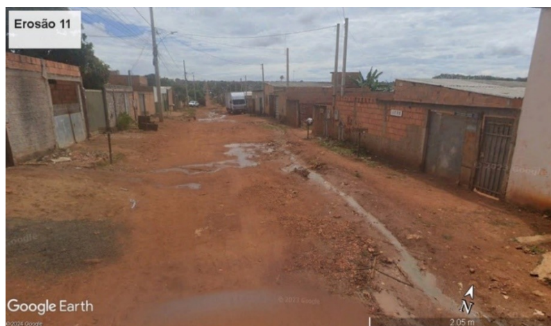
Figura 18. Erosão localizada no quarto quarteirão da rua Antônio Nunes de Souza
