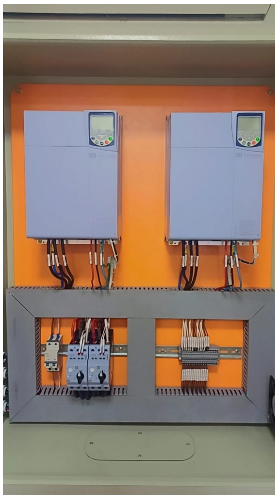
Figura 4.10 – Painel dos inversores dos sopradores.
