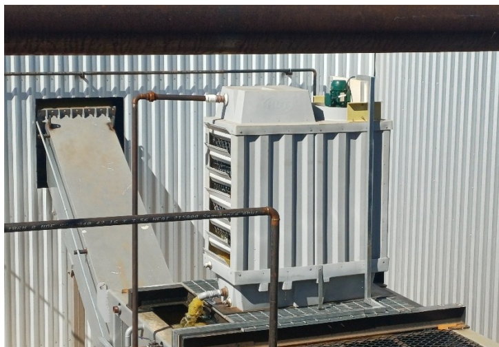
Figura 2.13 – Torre de Resfriamento.
