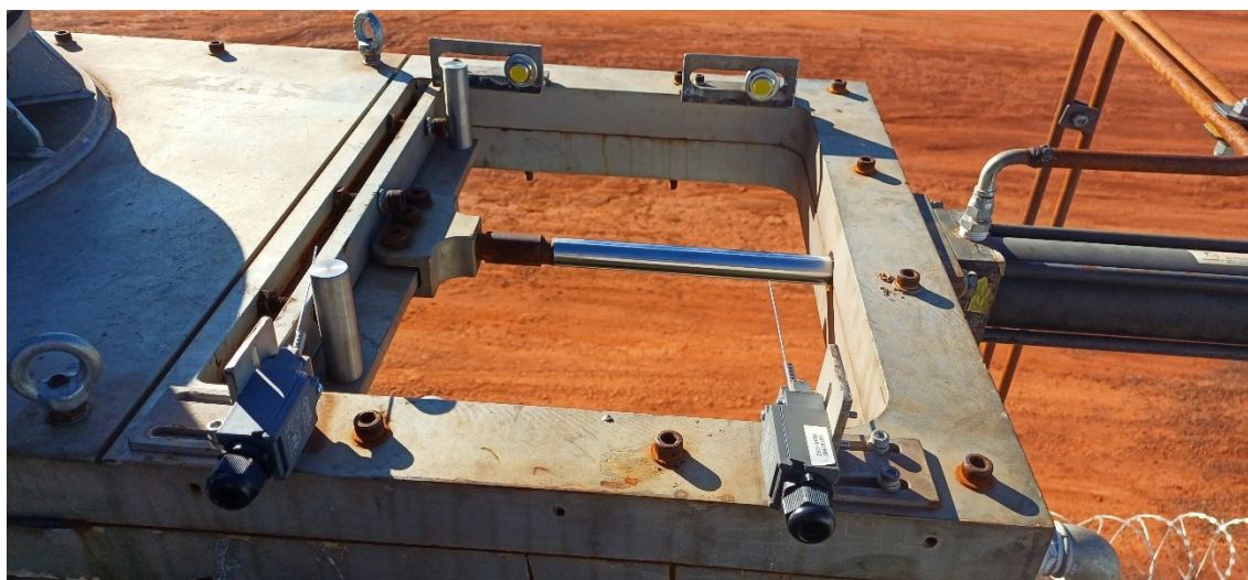
Figura 4.16 – Instalação dos sensores de fim de curso.
