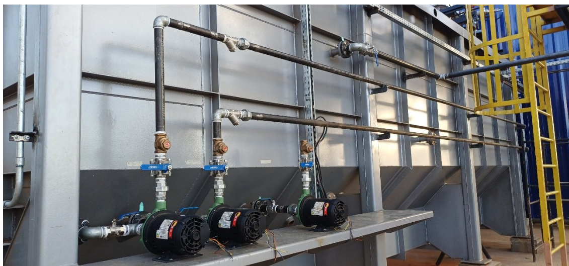
Figura 4.3 – Bombas de água.
