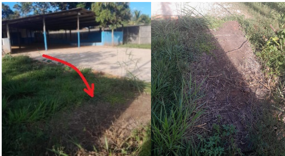
Figuras 10 e 11 – Detalhe da tampa da Fossa séptica na Associação de moradores
