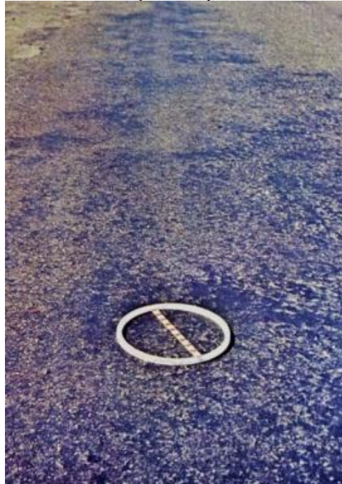
Figura 9 – Exsudação em pavimento asfáltico
