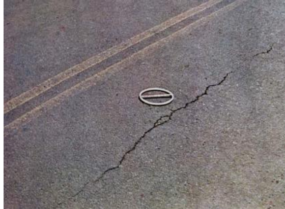
Figura 3 – Trincas em pavimento asfáltico
