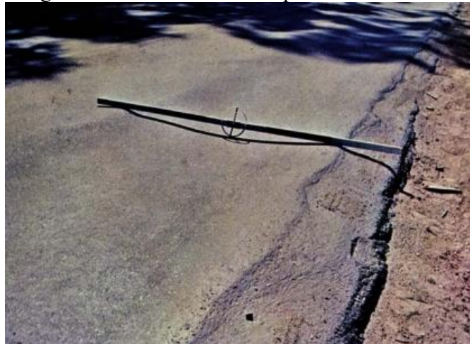
Figura 4 – Afundamento em pavimento asfáltico
