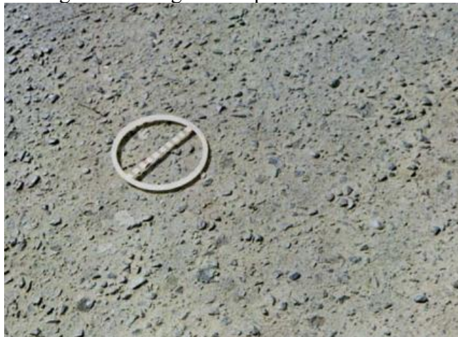
Figura 6 – Desgaste em pavimento asfáltico
