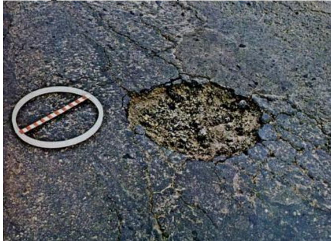
Figura 5 – Panela em pavimento asfáltico
