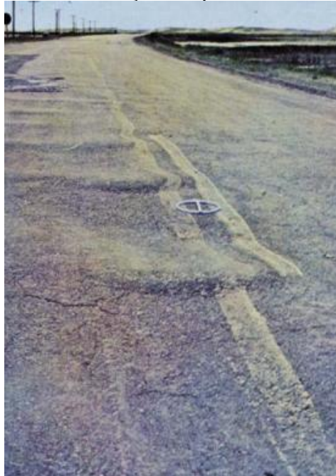
Figura 7 – Ondulação em pavimento asfáltico
