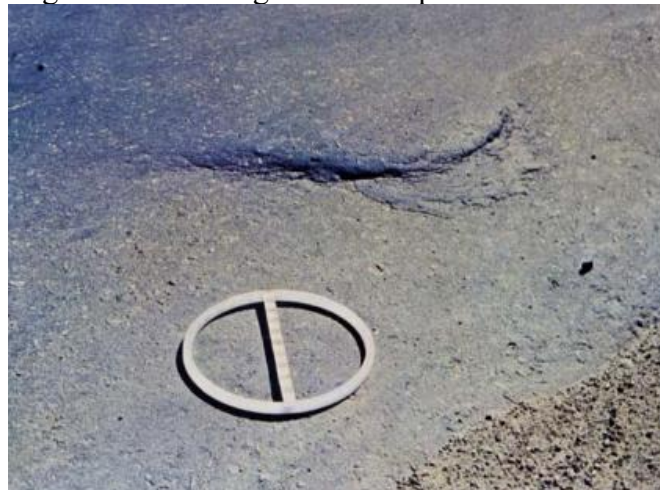
Figura 8 – Escorregamento em pavimento asfáltico
