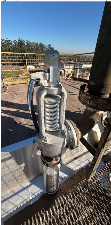
Figura 9 – Válvula PSV instalada em campo
