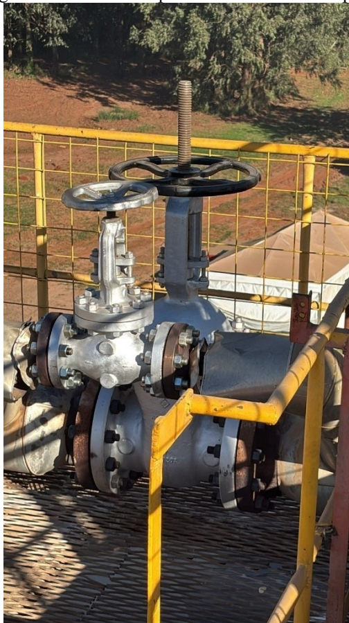
Figura 10 – Válvula de partida instalada em campo
