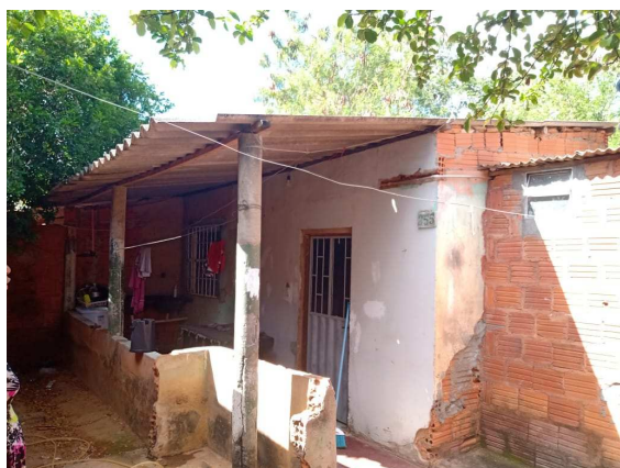
Figura 32 – Residências sem acabamentos, com ausência de reboco, pintura e revestimentos internos.
